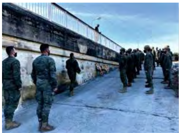
Detalle de las placas en la presa de El Grado y acto de homenaje a los caídos el 29 de octubre de 2020
